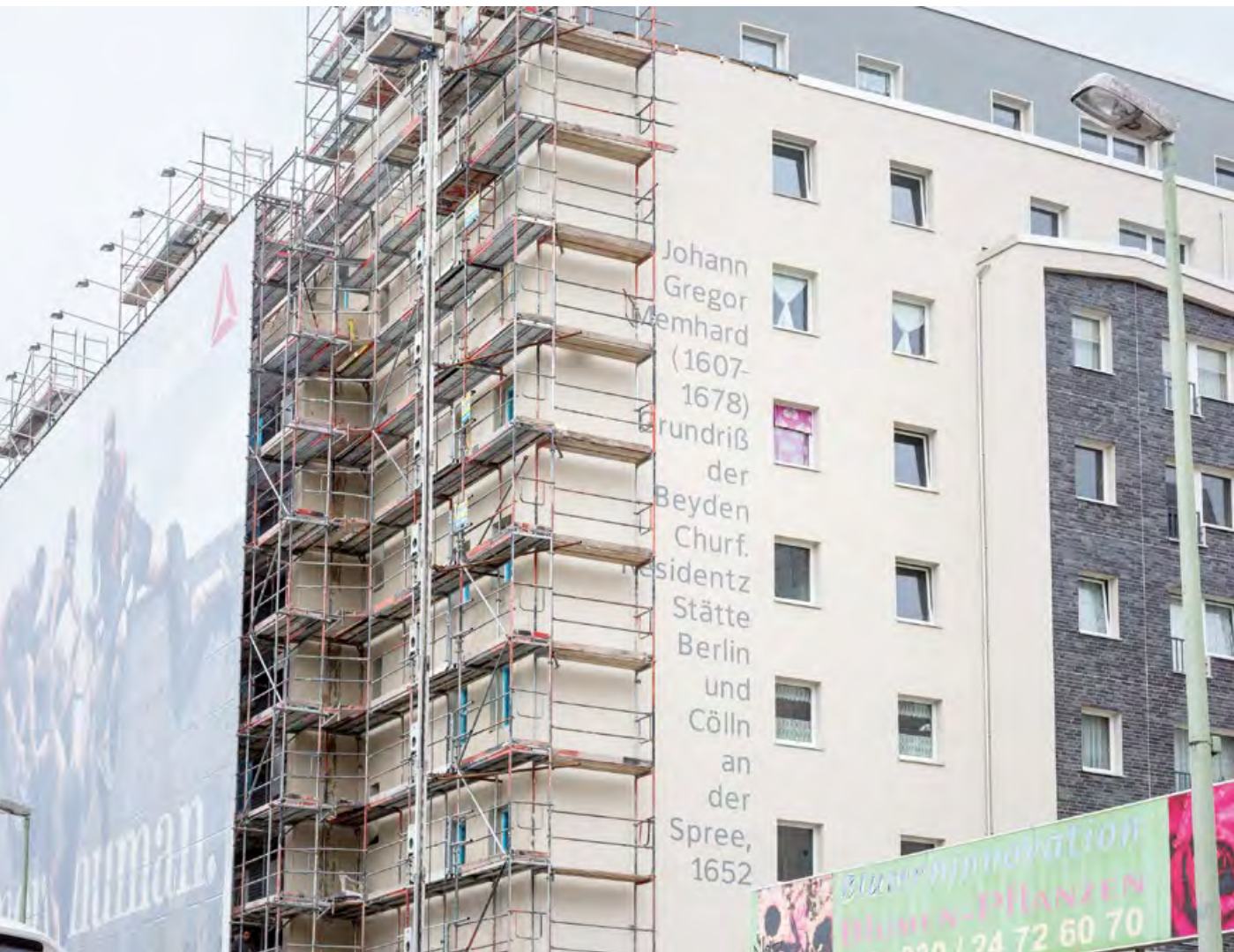
Durch den Umbau von Gewerbeeinheiten konnten 11 neue Wohnungen direkt am Alexanderplatz geschaffen werden
